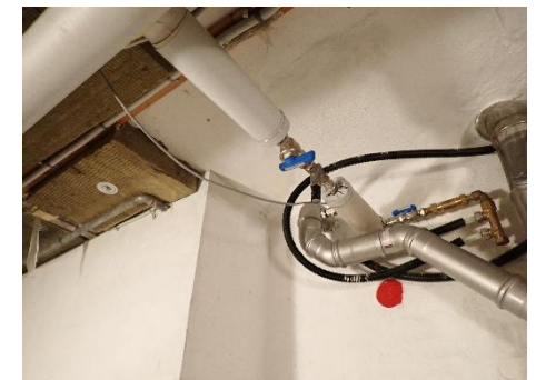
Vandinstallation i kælder
