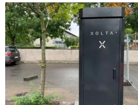
Eksempel på batterianlæg
