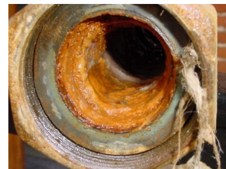
Eksempel på biofilm med slimdannelse i vandrør
