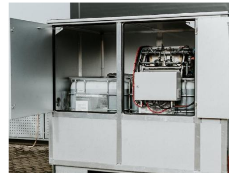
Eksempel på batterianlæg
