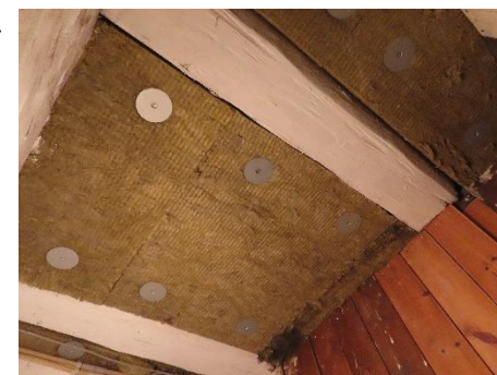
Isoleringspanel mellem etagebjælker
