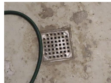
Gulvafløb i kælder
