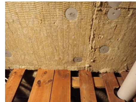
Isoleringspanel med skader på overflade
