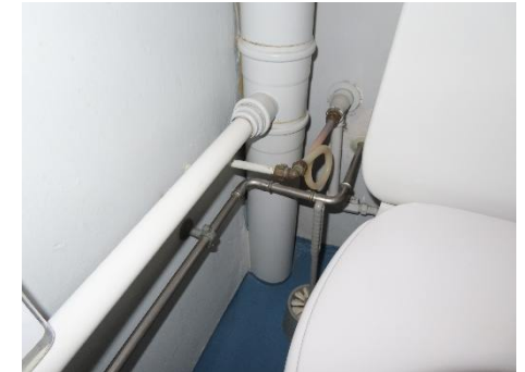
Vandinstallation i badeværelse
