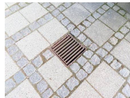
Overfladerist i gård
