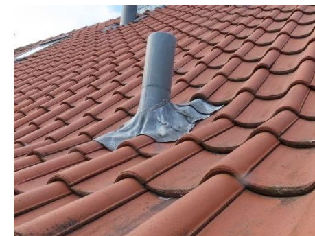
Utæthed ved faldstammeudluftning
