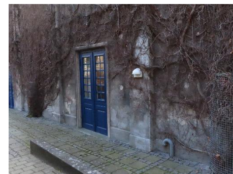
Nedslidt puds på biograf-facade
