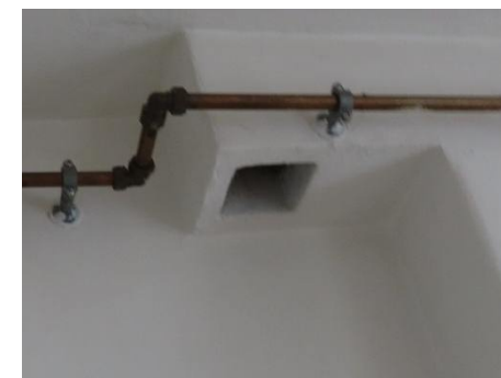
Ventilationskanal i lejlighed
