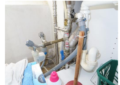
Vandinstallation i køkken
