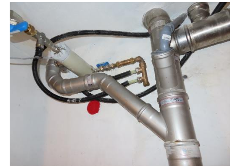
Faldstamme i kælder
