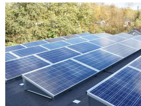
Eksempel på solcelleanlæg på fladt tag
