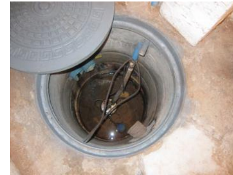
Drænpumpebrønd kælder (Foto 2015)
