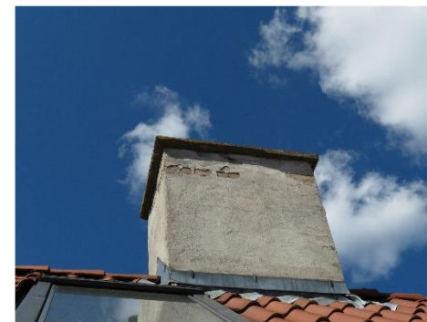
Afskalning på skorsten
