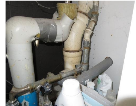
Køkkenfaldstamme i galvaniseret stål
