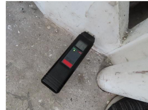
Fugtmåling i trappevange viser 15%
