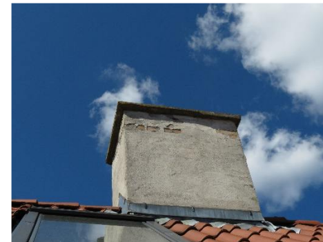
Afskalning på skorsten
