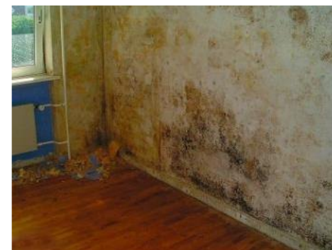
Eksempel på skade efter indvendig iso- lering Billedet er ikke fra jeres bygning
