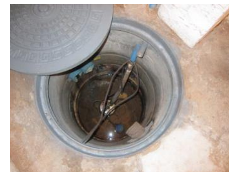
Drænpumpebrønd kælder (Foto 2015)
